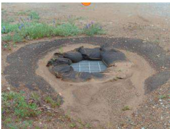
Figure 65 : Protection d'une grille avaloir
